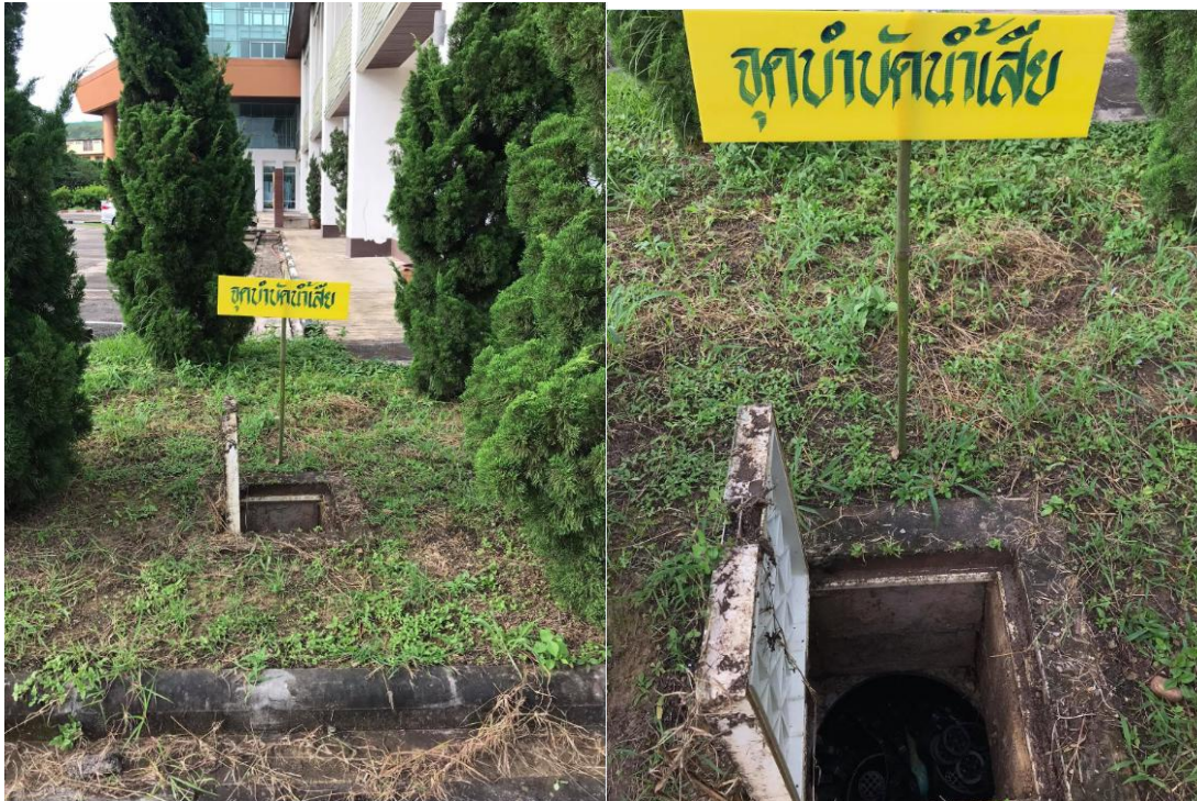
4.2.1 (3). ภาพถ่ายบ่อบำบัดน้ำเสียของอาคารเฉลิมพระเกียรติ
