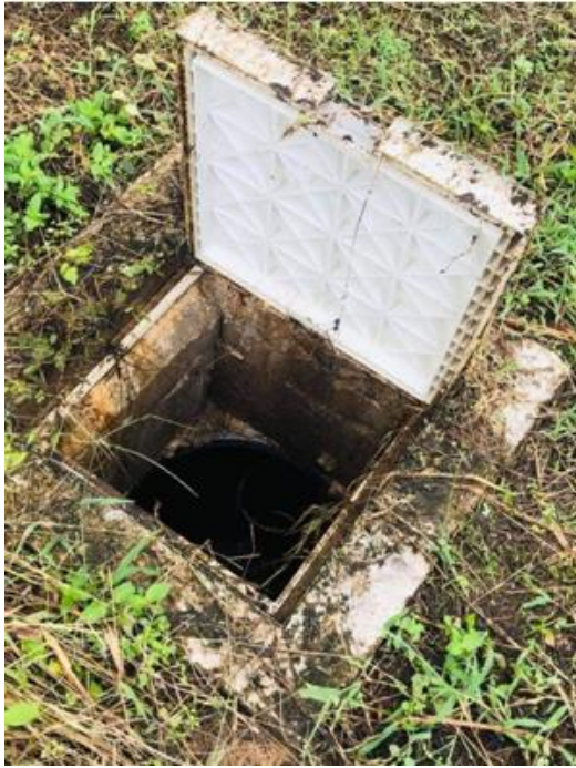
1. ตรวจสอบสภาพฝาและบริเวณรอบบ่อบำบัดน้ำเสีย สามารถ ปิด-เปิด หรือ ชำรุด/แตกหัก หรือ ไม่
