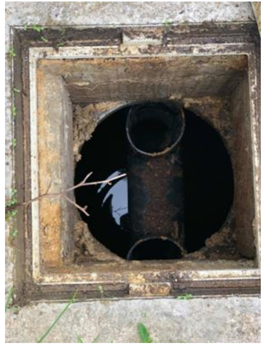
2. ตรวจสอบน้ำในบ่อบำบัดน้ำเสีย
